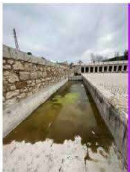
PÉRDIDA DE ESTANQUIDAD
