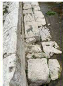
ROTURA DE SILLARES
