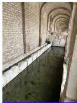
FÁBRICAS DE LADRILLO DETEGRADA, PÉRDIDA DE VOLUMETRÍA Y PRESENCIA DE VEGETACIÓN.
